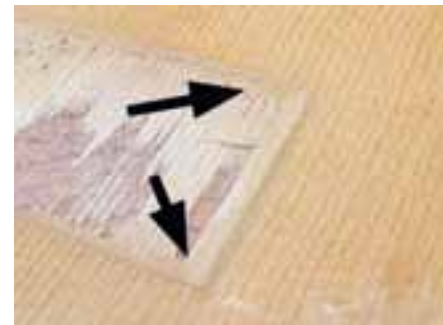
Abb. 3: Die unsauber ausgearbeitete Kontaktfläche Decke/Steg
